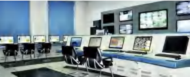
电厂视频监控系统应用
