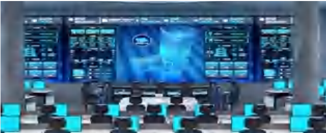
变电站监控系统
